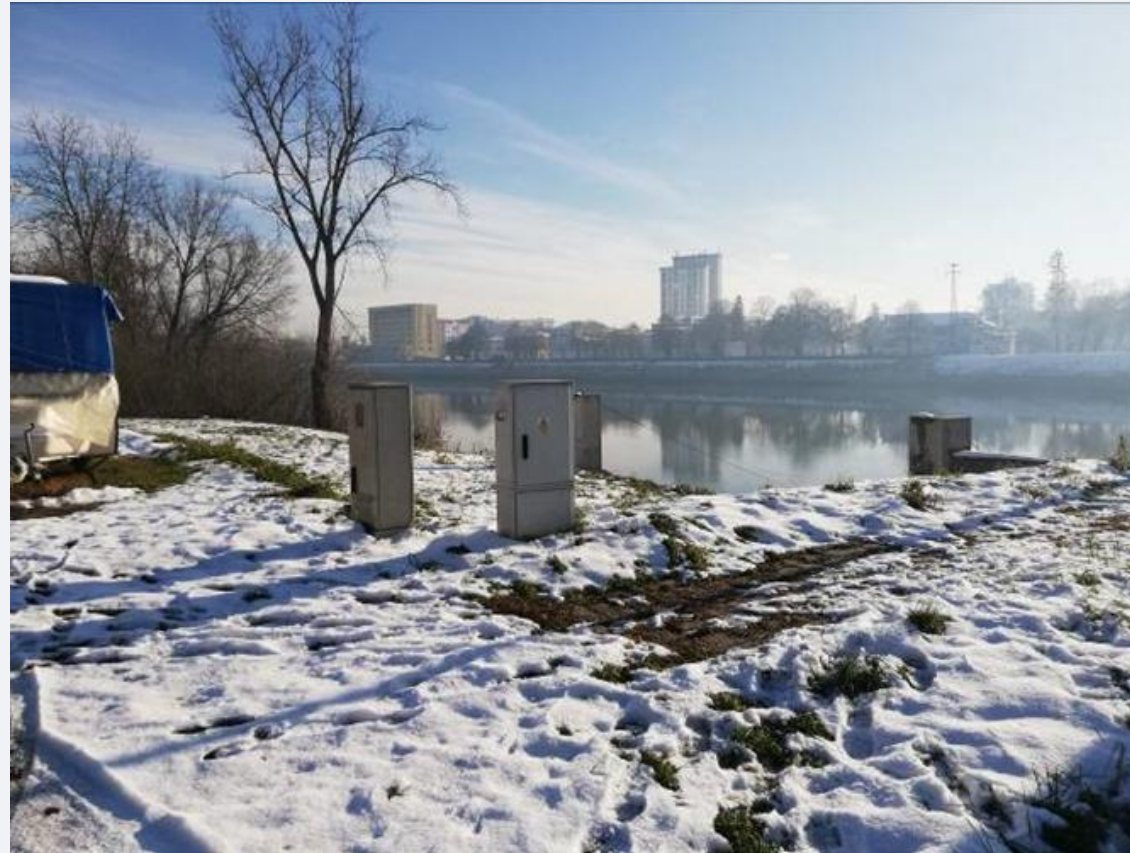
Električni ormarici u blizini pristaništa za patrolne čamce
